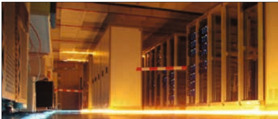
Bahnhofs datahall kommer til å bli Stockholms største når den oppføres i 2016-2017. Fullt utbygd kan den gjenvinne 112 gigawattimer varme fra kjøleanlegget per år till fjernvarmenettet. Det tilsvarer en by med cirka 20.000innbyggere.
