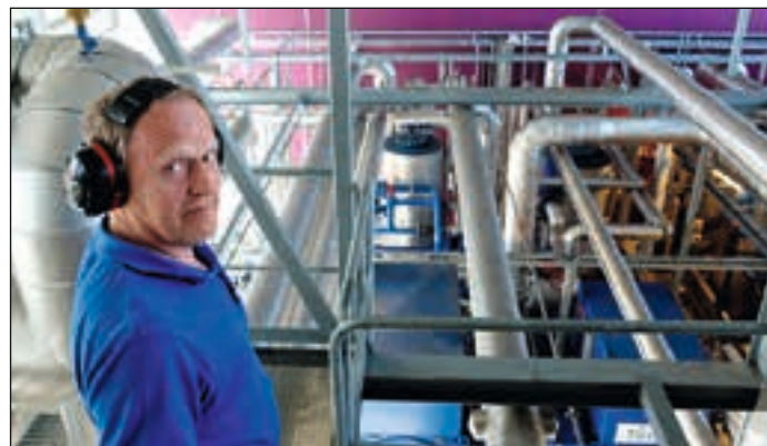
Produksjonsleder Vidar Mathisen skuer ut over den enorme varmepumpen de har bygget på Brakerøya i Drammen. Anlegget sørger for varme i alle større bygninger i Drammen sentrum, hvilket tilsvare mellom 3000- 4000 eneboliger Foto Pernille Vestengen.
